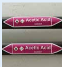
Marquage de tuyauterie
