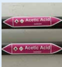
Marquage de tuyauterie
