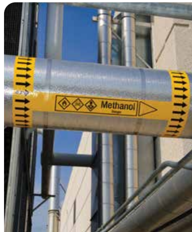
Marquage de tuyauteries
