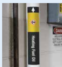
Marquage de tuyauterie
