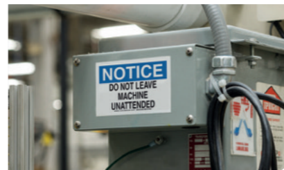
Panneaux de sécurité
