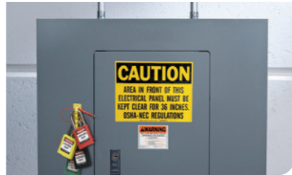
Identification de tableaux et de coffrets électriques
