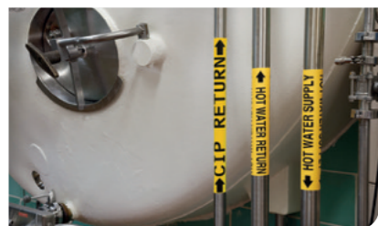
Marqueurs de tuyauteries
